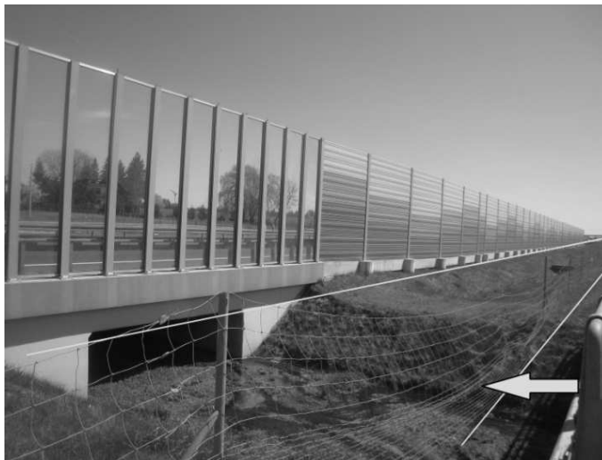
RYSUNEK 2. Przezroczyste i aluminiowe ekrany akustyczne oraz ogrodzenie (strzałka) na odcinku Grójec – Białobrzegi
